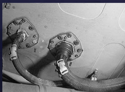
Braided metal conduits
